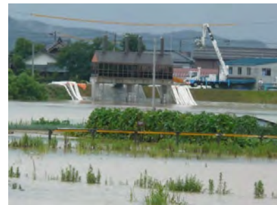
三条市大野畑地先 貝喰川樋門(信濃川) 排水ポンプ車・照明車
